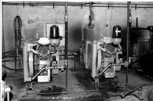
Pompe de aer comprimat
