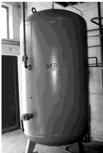
Rezervor de aer comprimat
